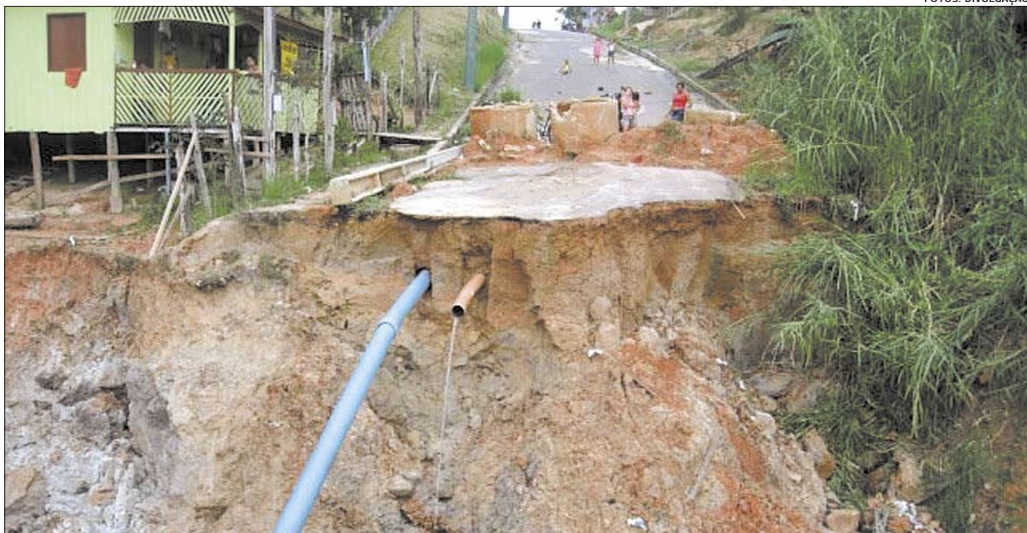
Segundo a denúncia, a rua São Francisco localizada no município de Carauari desabou devido a ausência de saneamento básico
